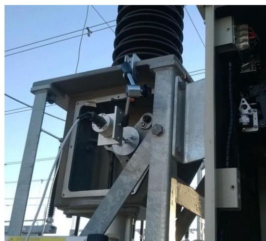
Rysunek 2: Cyfrowy przetwornik obrotowy zamontowany na SF6 LTB 245 kV
