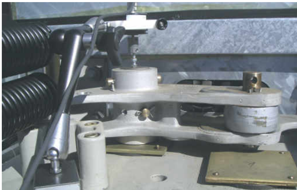
Pomiar ruchu w mechanizmie wyłącznika.
